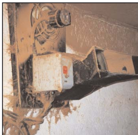
Un ventilateur qui donne une idée de l'état des lieux...
